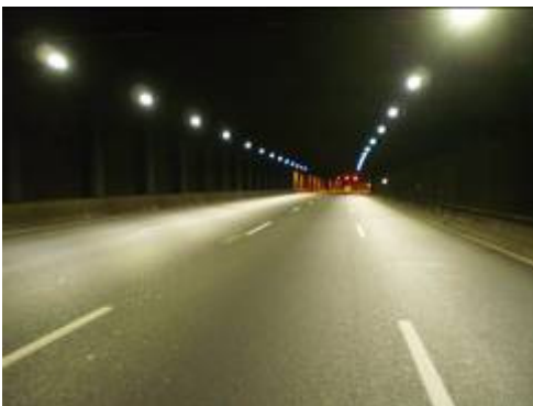
Túnel M-40 Led Fabricante 1 30%
