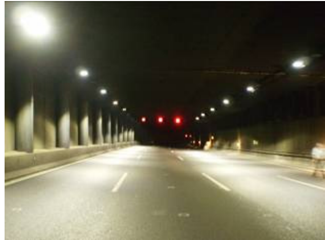
Túnel M-40 Led Fabricante 2 100%
